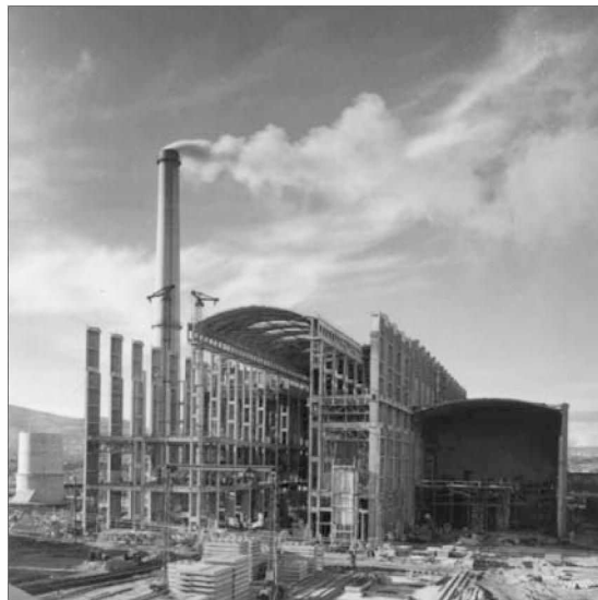
A főépület: bunkertér, kazánház, tápház, gépház
